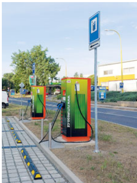
Dobíjecí stojany mají výkon 50 kW.
