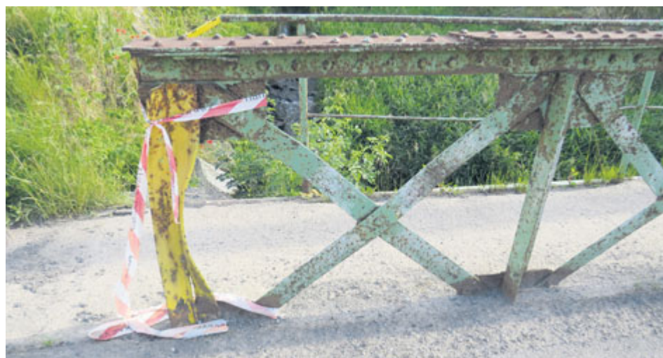
Na opravu čeká most v ulici Pod Kovárnami. Je třeba opravit celou nosnou konstrukci, vyrovnat svislice, před hlavní nosníky osadit svodidla a umístit značku omezující zatížitelnost.
