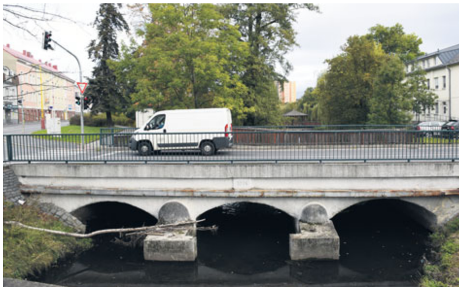
Na mostu v ulici Špitálská bude třeba vyměnit zábradlí a vyčistit koryto a uliční vpusti.
