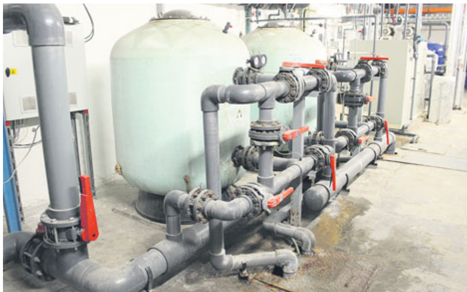
Strojní zázemí aquaparku nutně vyžaduje rekonstrukci.
