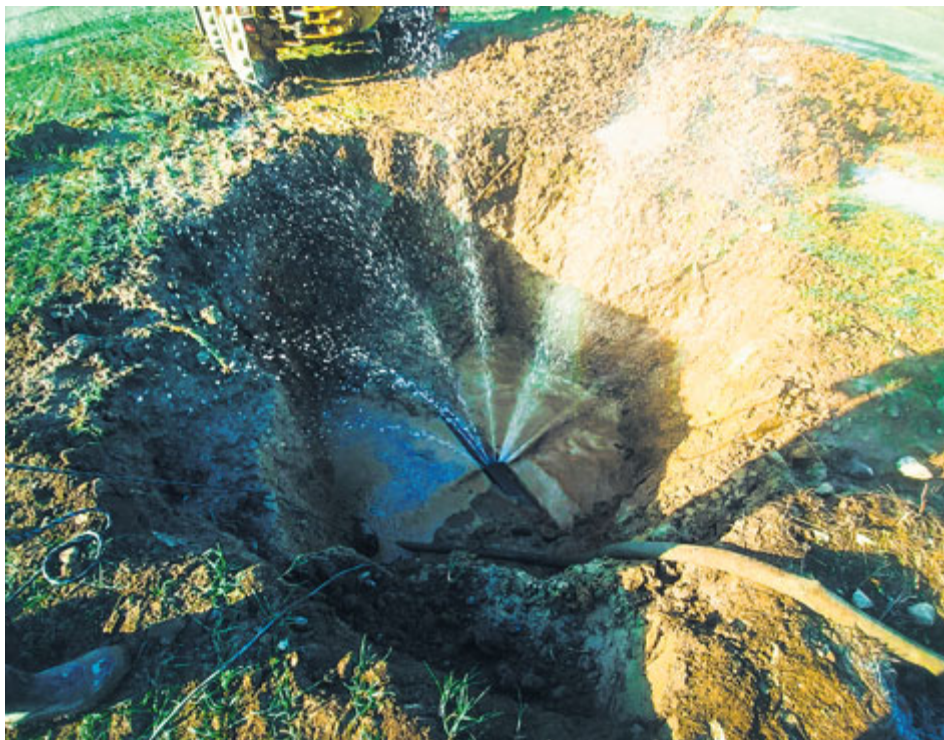
Situaci, kdy voda prýští ze starého vodovodního řadu, by mělo postupně ubývat.
