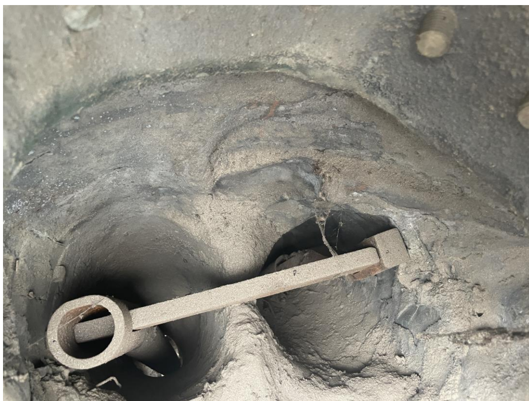
Otevření zad a pohled na již nevyhovující konstrukci
