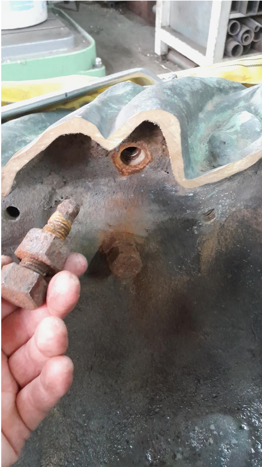
Původní zkorodované stahovací šrouby
