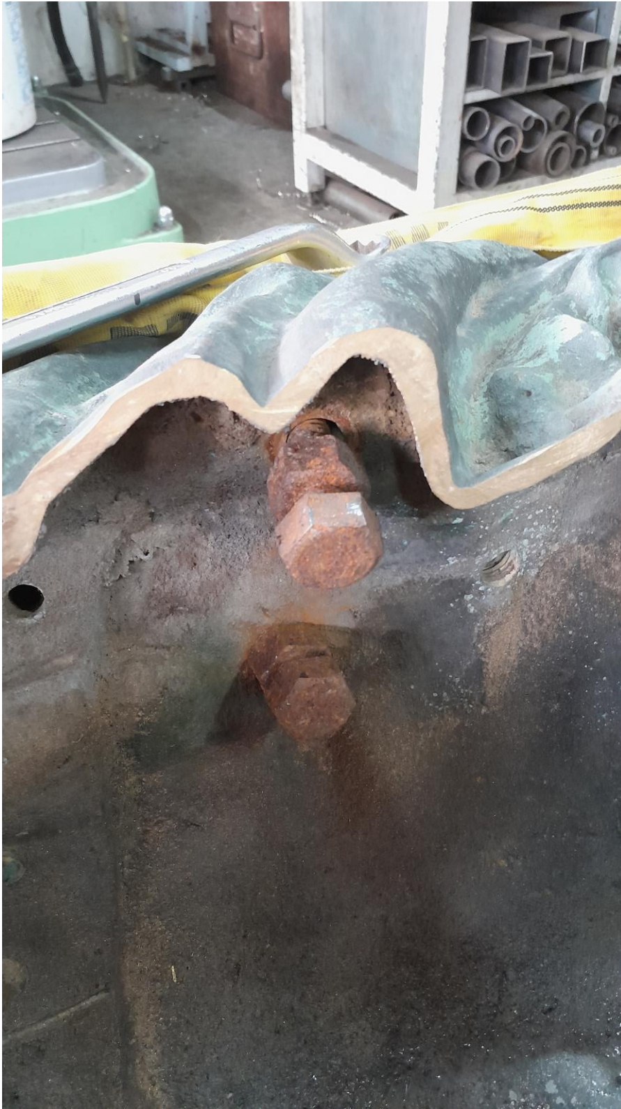
Původní zkorodované stahovací šrouby
